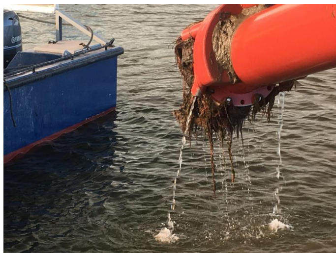
Figura 85: Comum entupimento da lança
