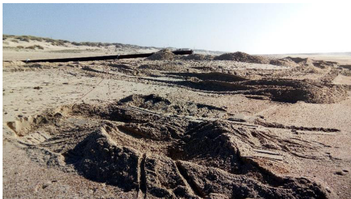
Figura 42: Término da linha de transposição de sedimentos - local de enterramento de um dos ferros de sustentação
