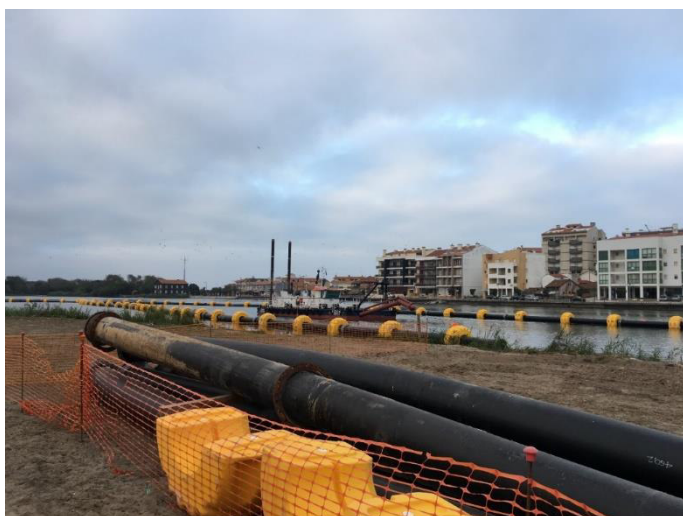
Figura 12: Tubagem de repulsão por montar
